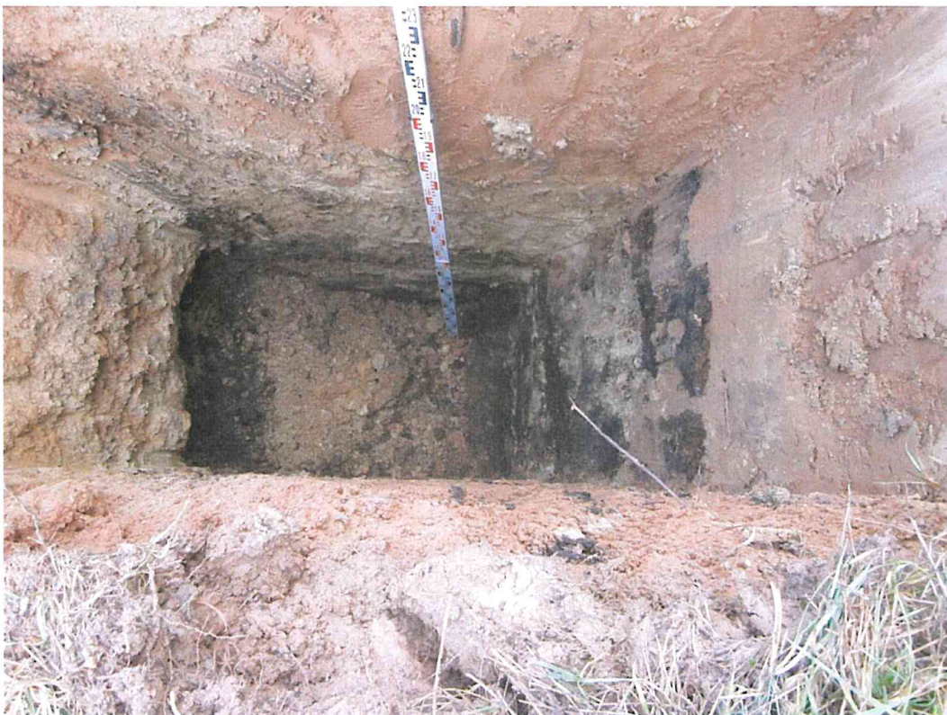
Bild 4: Schurf 2 bei RKS 7, ab einer Tiefe von ca. 3,0 m anstehendes dunkelbraunes bis schwarzes, organisches Material
